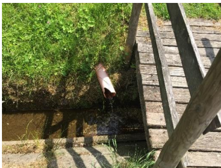
ABBILDUNG 16: WASSEREINTRITT IN DEN GRABEN
