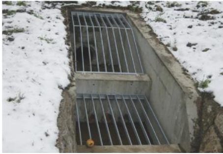
ABBILDUNG 18: GERÖLFFANG VOR EINLAUF IN VERROHRUNG (QUELLE: STADT BUCHEN, AUS: IBH – STARKREGENBROSCHÜRE)
