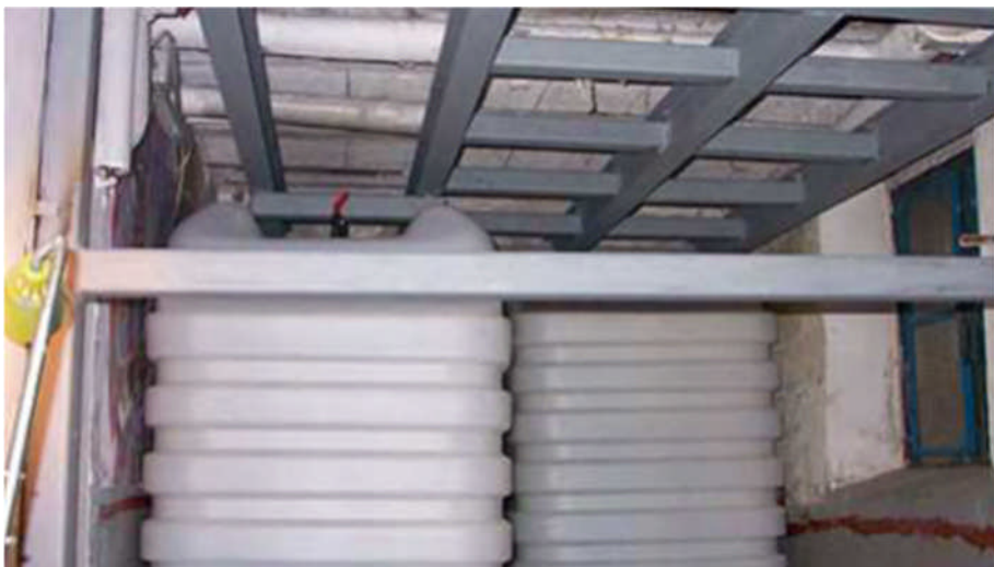
ABBILDUNG 10: HEIZÖLTANKANLAGE MIT AUFTRIEBSSICHERUNG (QUELLE: HOCHWASSERSCHUTZFIBEL, 2018)
