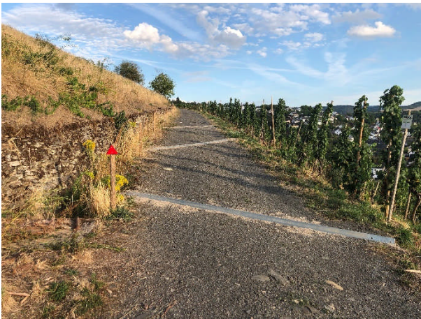
ABBILDUNG 23: MEHRFACHE KLEINRÄUMIGE WEGEABSCHLÄGE (FOTO INCA,03.09.2022)
