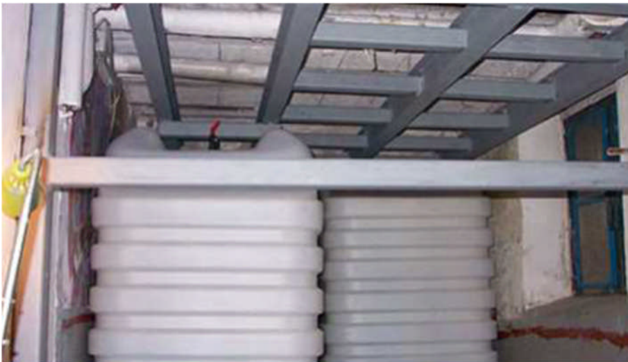
ABBILDUNG 10: HEIZÖLTANKANLAGE MIT AUFTRIEBSSICHERUNG (QUELLE: HOCHWASSERSCHUTZFIBEL, 2018)
