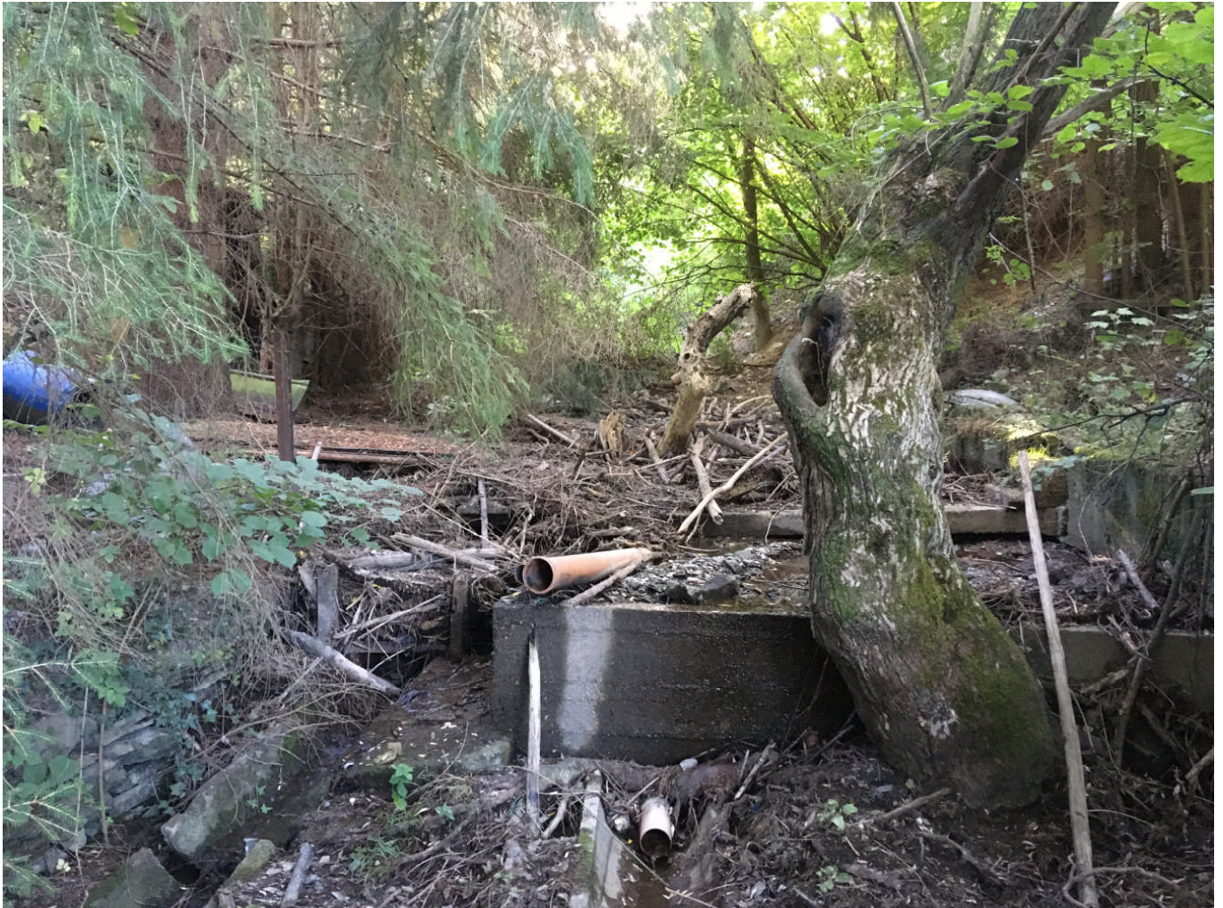
ABBILDUNG 11: UNSACHGEMÄßE LAGERUNG VON UNRAT UND VERLEGUNG DES GEWÄSSERS AM MÖRTSCHELBACH IN WALDRACH
