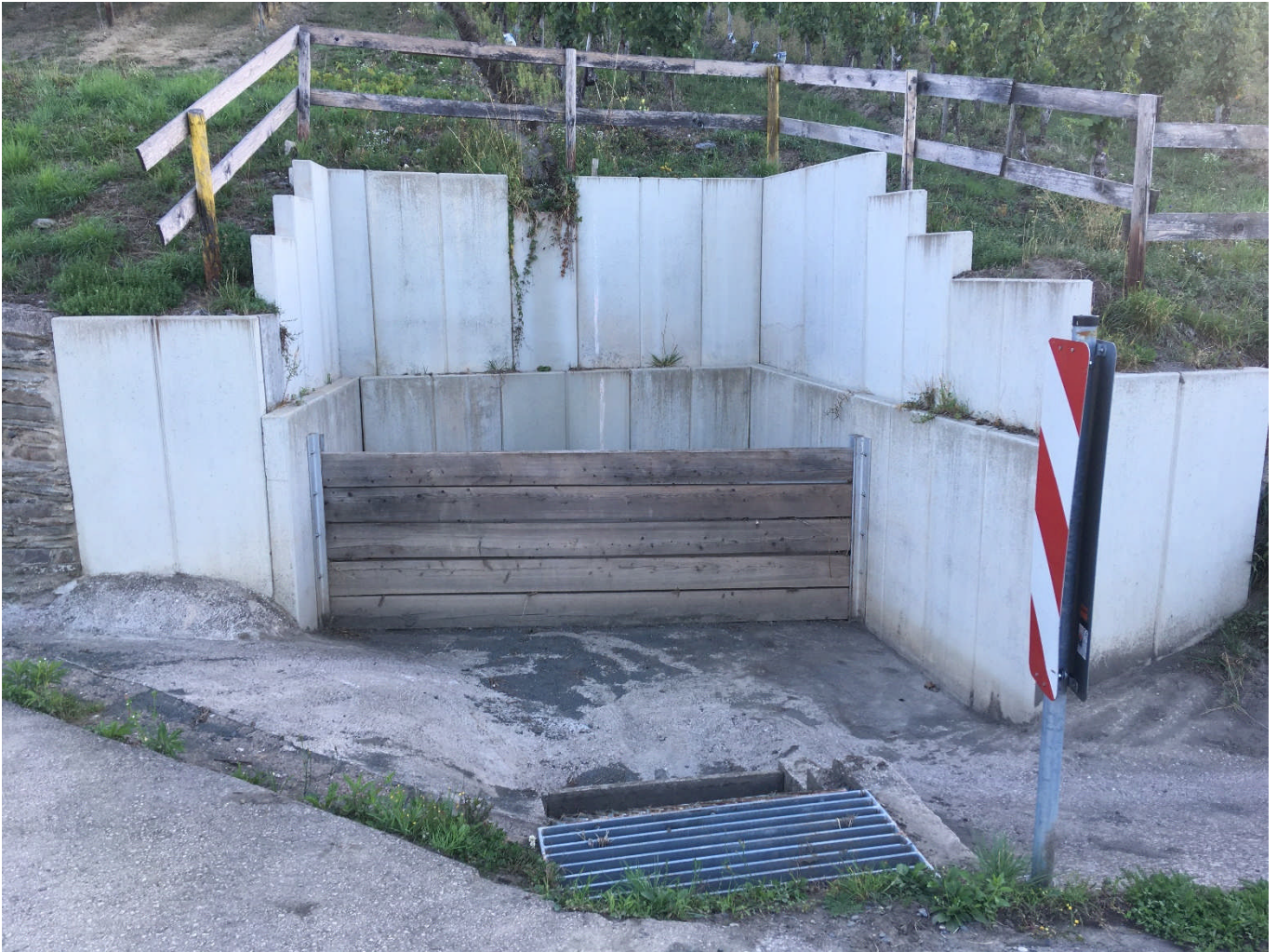
ABBILDUNG 21: SANDFANG EINES ABLEITUNGSGRABENS IN WALDRACH (FOTO INCA, 2021)
