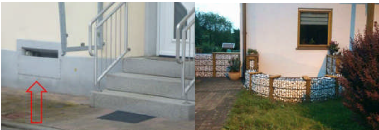
ABBILDUNG 13: GESICHERTE KELLERFENSTER (QUELLE: OBERMEYER PLANEN UND BERATEN GMBH)
