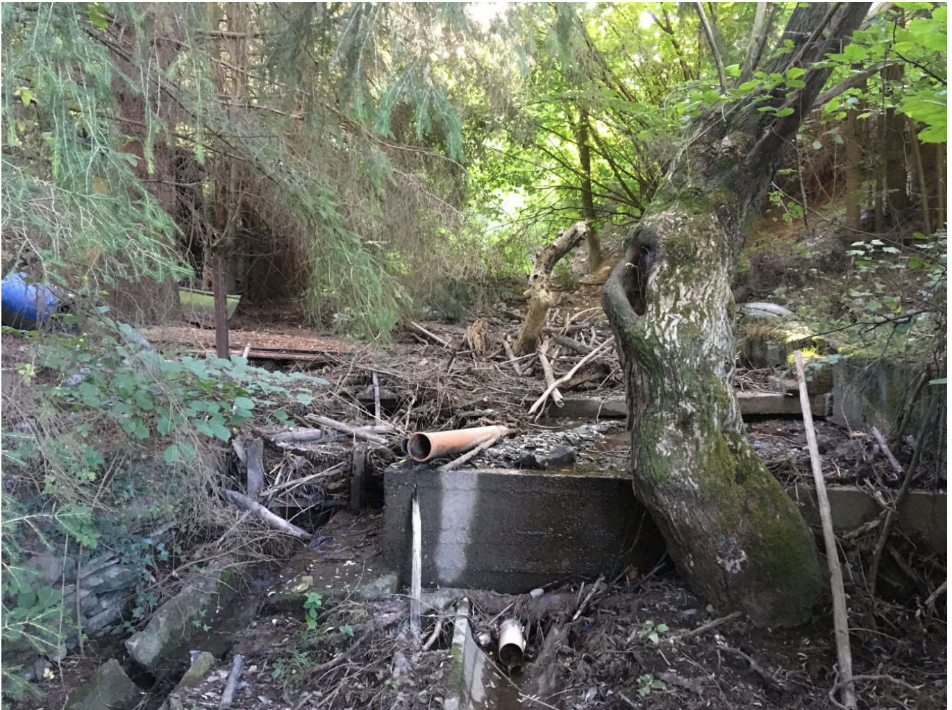
ABBILDUNG 15: UNSACHGEMÄßE LAGERUNG VON UNRAT UND VERLEGUNG DES GEWÄSSERS AM MÖRTSCHELBACH IN WALDRACH
