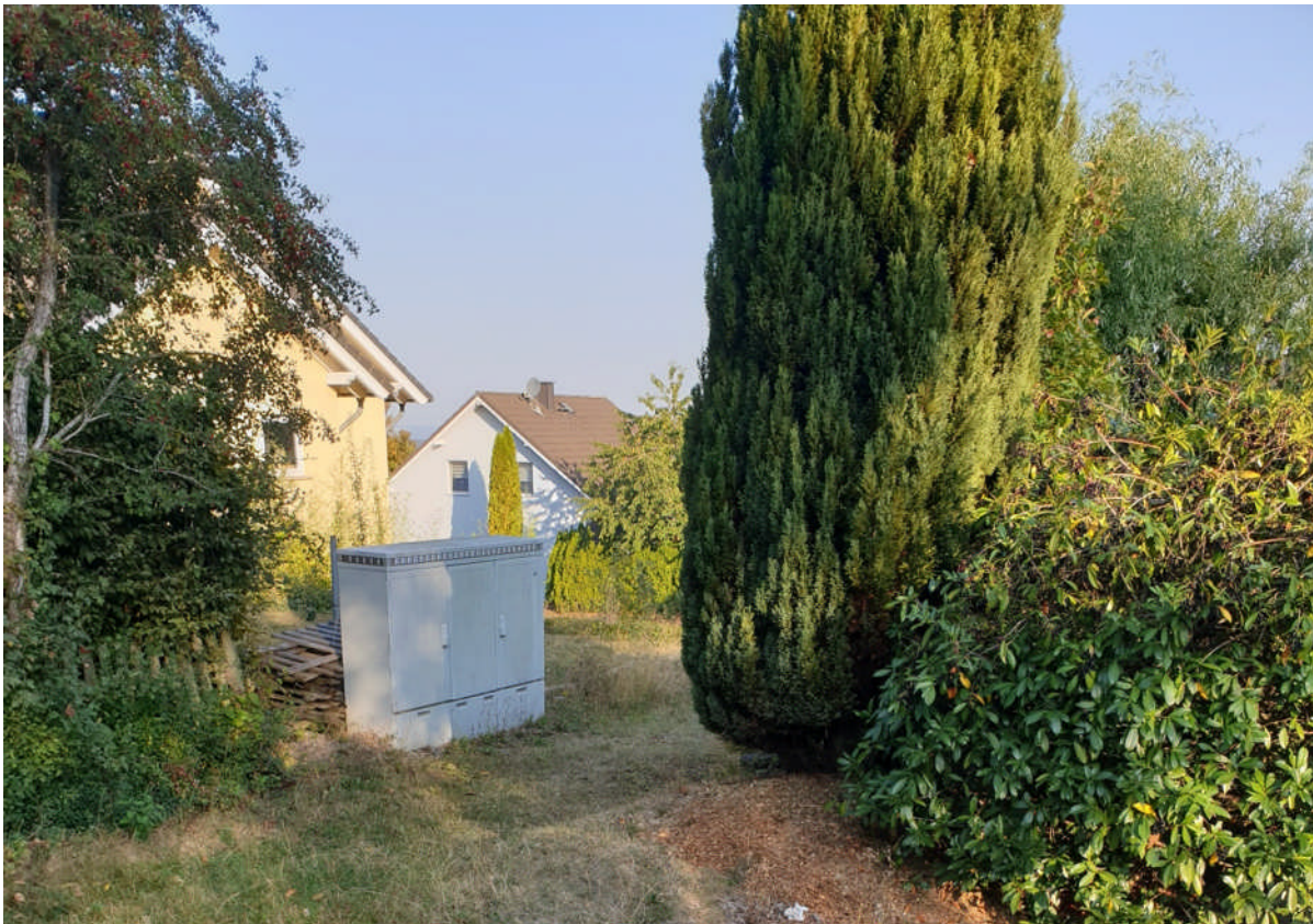
ABBILDUNG 33: KRITISCHE INFRASTRUKTUR (HIER TELEKOMMUNIKATION) IM NOTÜBERLAUF EINES RETENTIONSBECKENS IN OSBURG (FOTO INCA, 2021)
