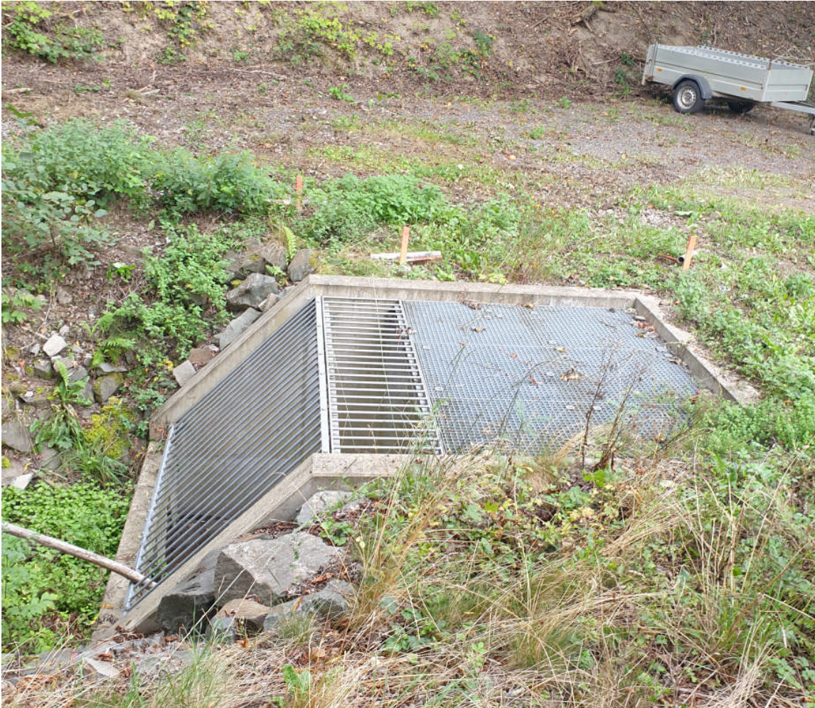
ABBILDUNG 19: HYDRAULISCH OPTIMIERTER EINLAUF IN KASEL (FOTO INCA, 2021)
