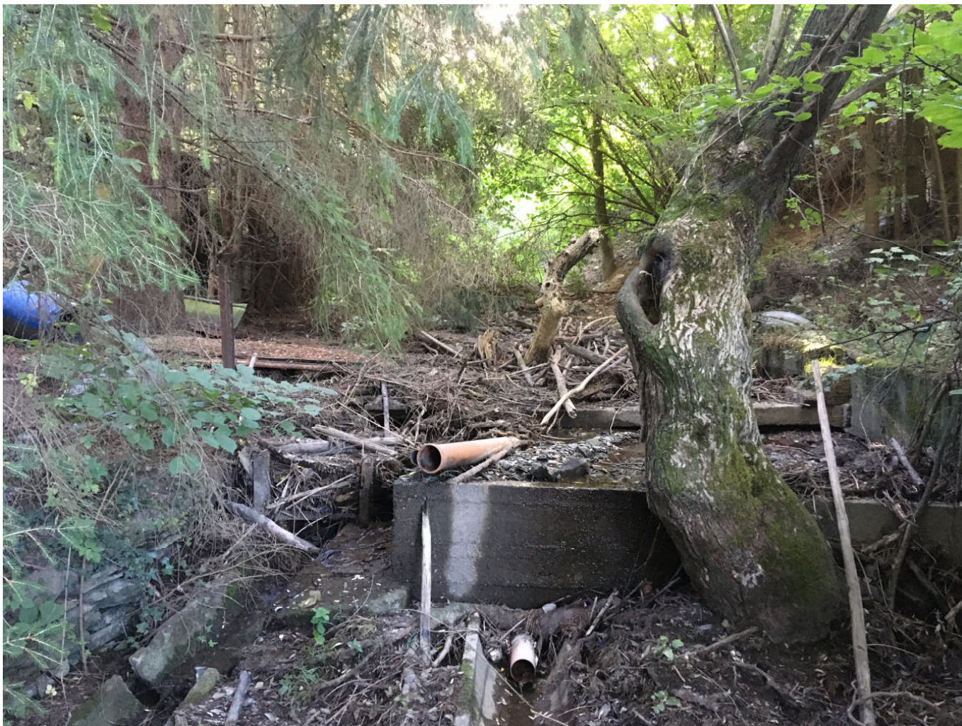
ABBILDUNG 11: UNSACHGEMÄßE LAGERUNG VON UNRAT UND VERLEGUNG DES GEWÄSSERS AM MÖRTSCHELBACH IN WALDRACH
