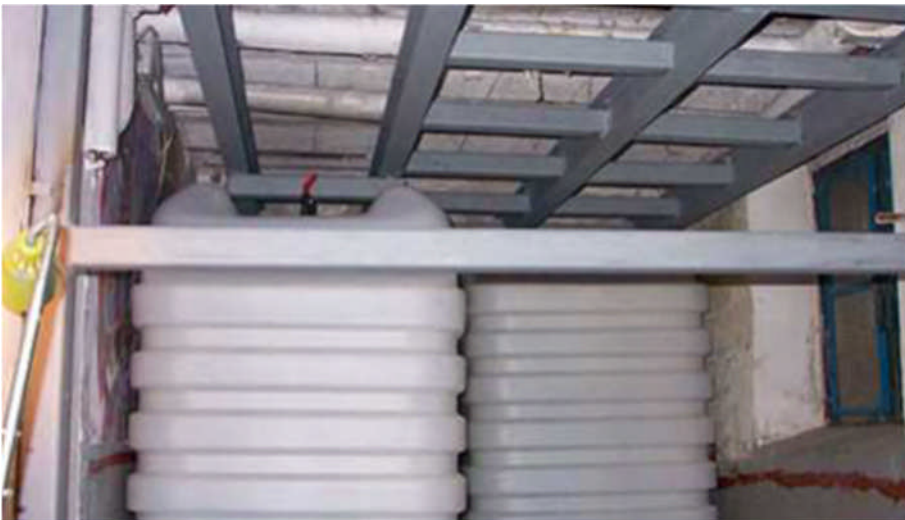
ABBILDUNG 10: HEIZÖLTANKANLAGE MIT AUFTRIEBSSICHERUNG (QUELLE: HOCHWASSERSCHUTZFIBEL, 2018)
