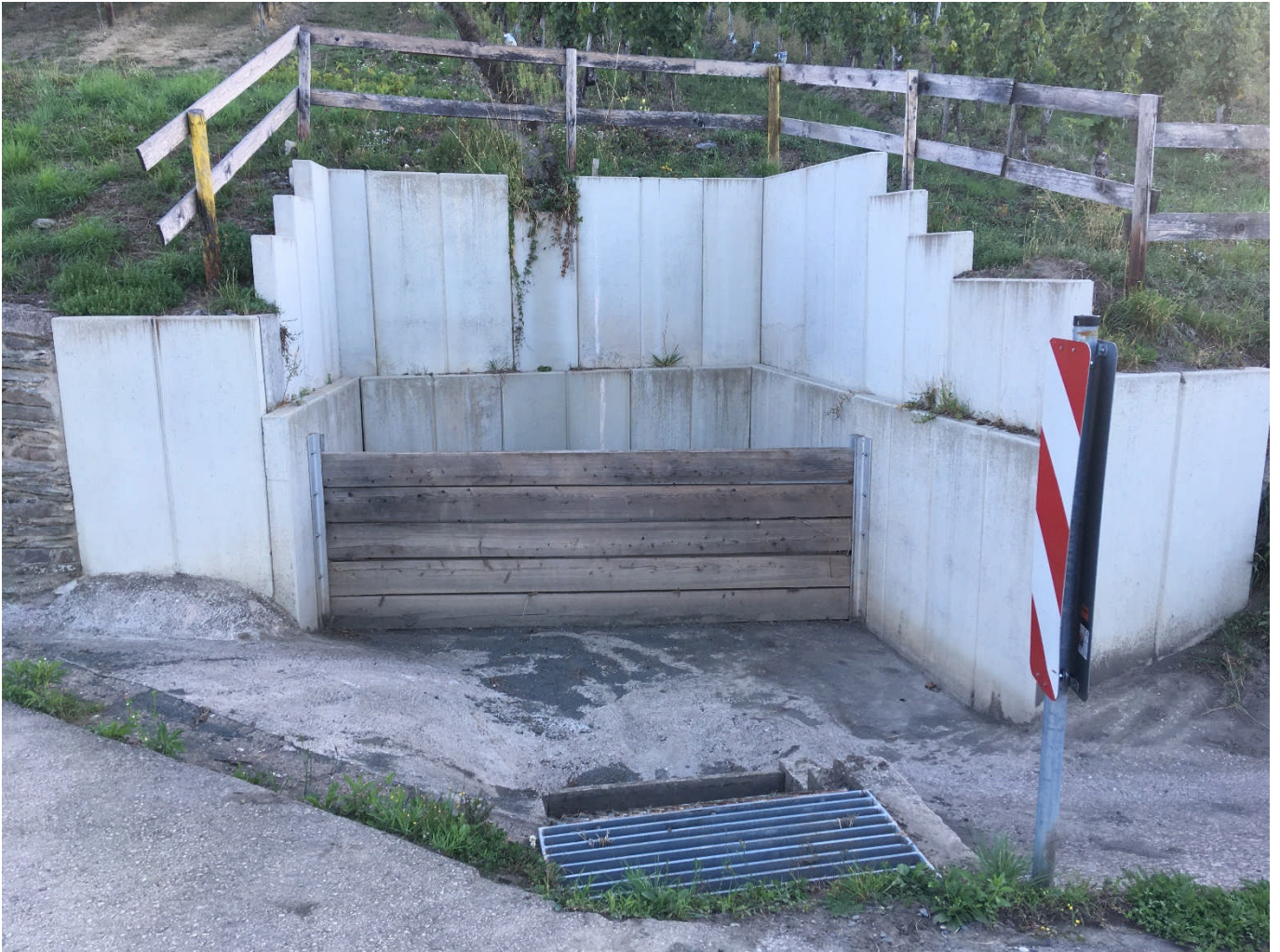
ABBILDUNG 17: SANDFANG EINES ABLEITUNGSGRABENS IN WALDRACH (FOTO INCA, 2021)
