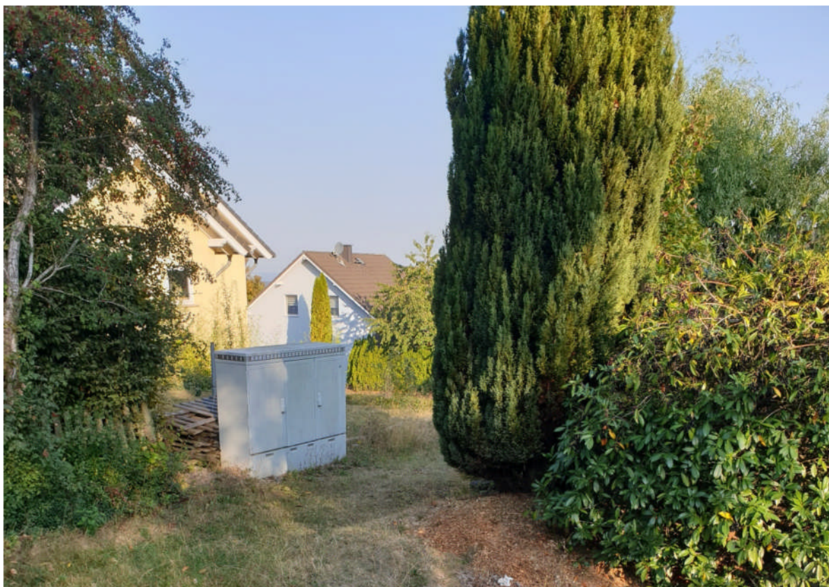
ABBILDUNG 29: KRITISCHE INFRASTRUKTUR (HIER TELEKOMMUNIKATION) IM NOTÜBERLAUF EINES RETENTIONSBECKENS IN OSBURG
