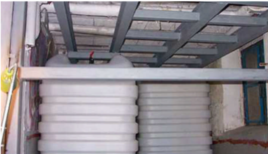
ABBILDUNG 10: HEIZÖLTANKANLAGE MIT AUFTRIEBSSICHERUNG (QUELLE: HOCHWASSERSCHUTZFIBEL, 2018)
