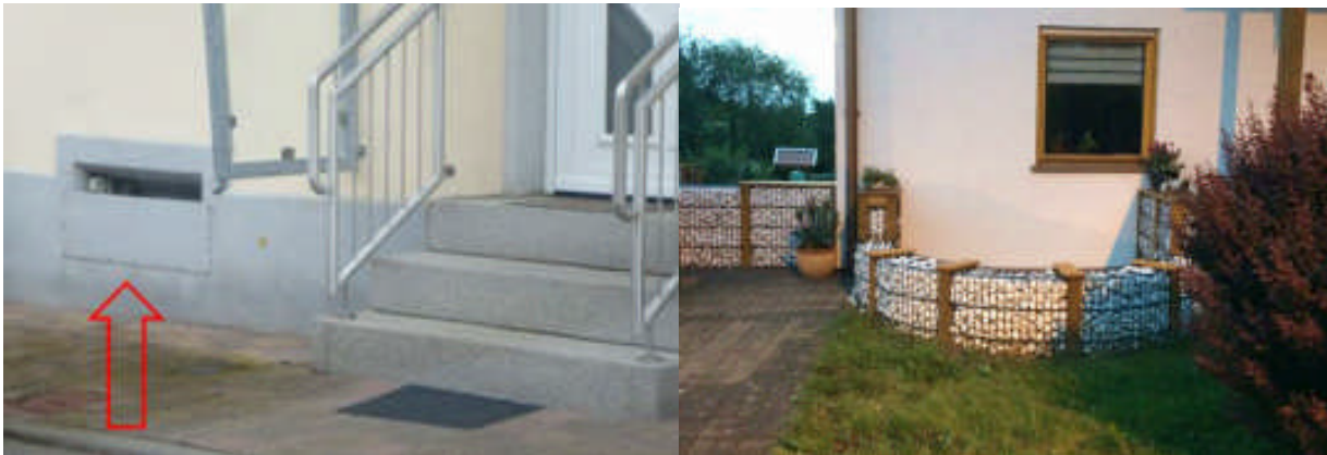
ABBILDUNG 9: GESICHERTE KELLERFENSTER (QUELLE: OBERMEYER PLANEN UND BERATEN GMBH)
